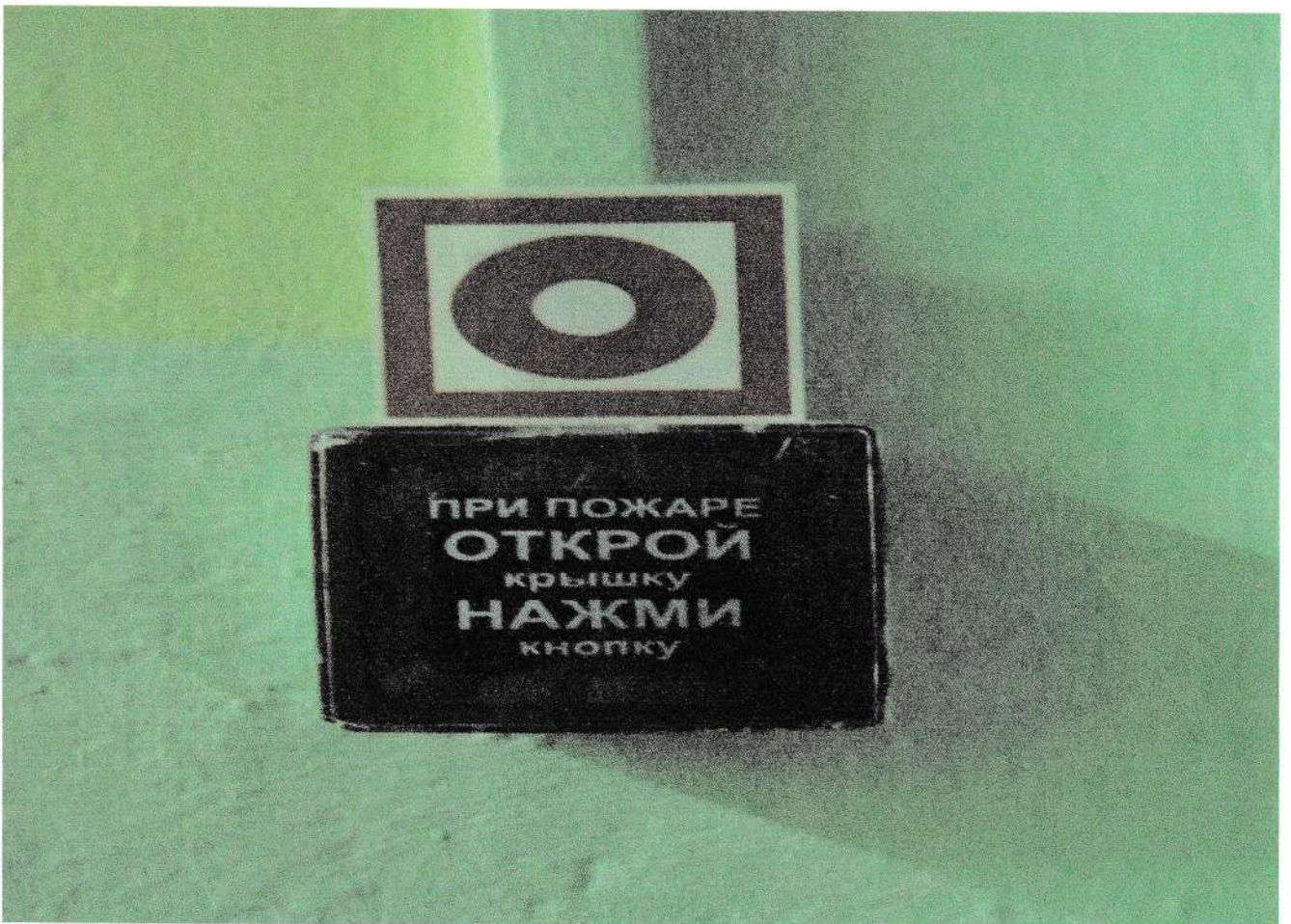
Фото 31 Кнопка пожарной сигнализации
